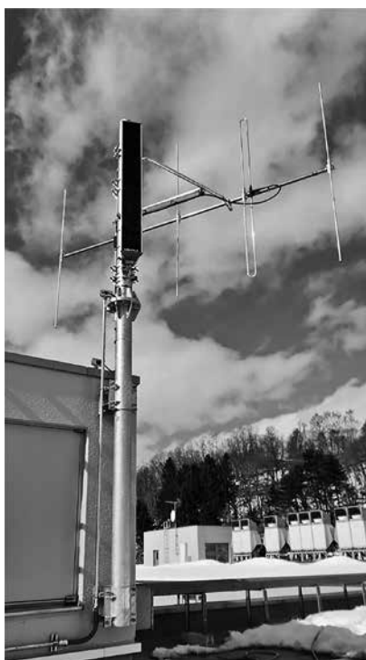
役場屋上に設置した アンテナとスピーカー
